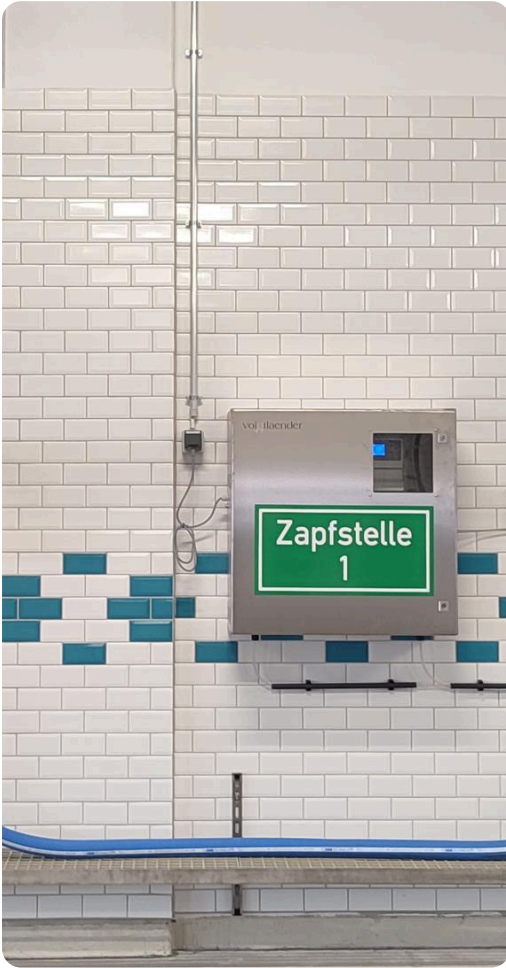
Reale Trinkwasserfüllstation: Der technische Zustand ist nur ein Teil der Freigabe; Schutz, Reinigung und dokumentierter Betrieb vervollständigen die Barriere.
