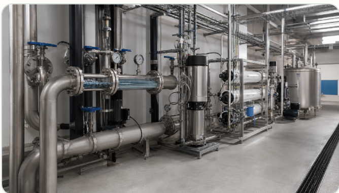
Betriebsleistung entsteht im Zusammenspiel von Anlage, Messung, Wartung und dokumentierter Reaktion.
